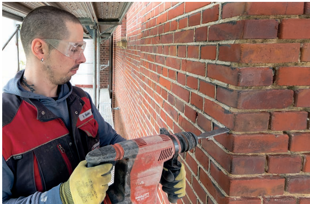
Die teils stark ausgebrochene Altverfugung wurde vorsichtig mit einem speziellen Flachmeißel entfernt.
