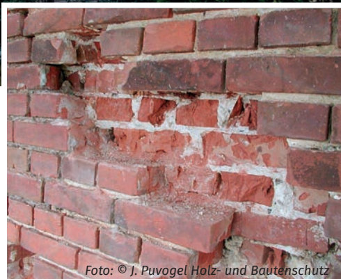
Das Mauerwerk wies starke Schäden auf.
